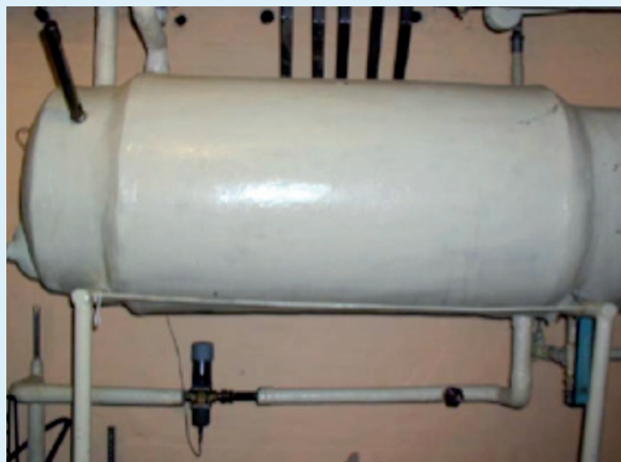
Ældre vandretliggende varmtvandsbeholder
