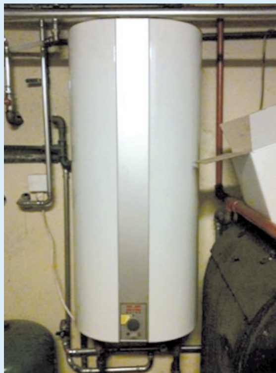
Nyere lodretstående varmtvandsbeholder
