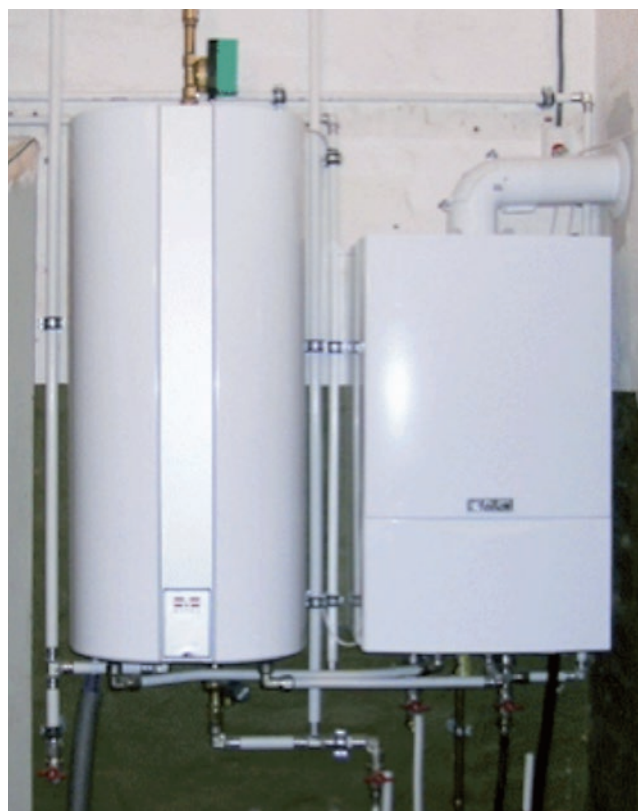
Ny varmtvandsbeholder med ny gaskedel
